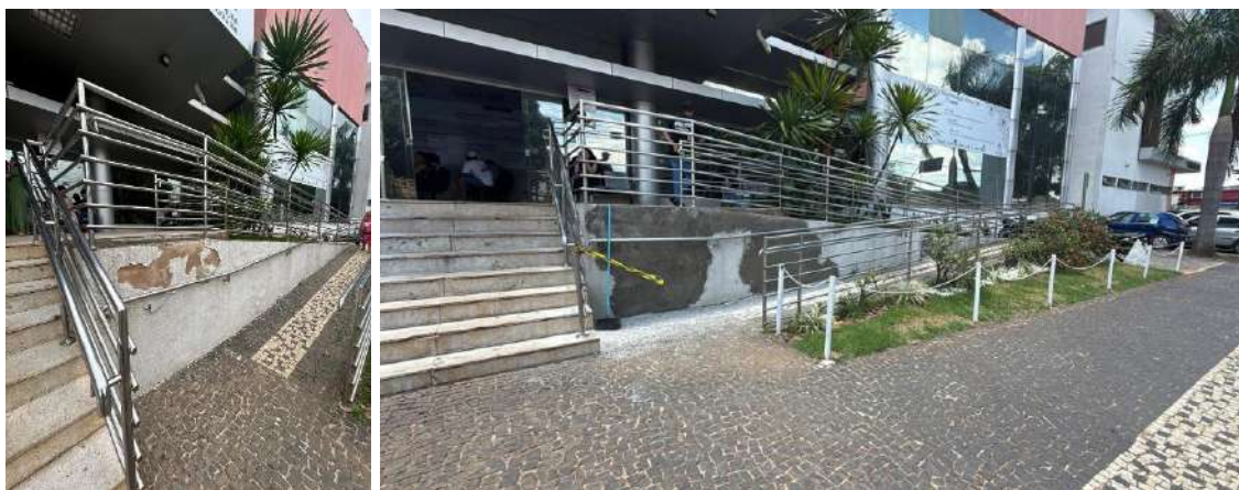
Rampa de acesso com paredes descascadas e com infiltrações. Iniciando corretiva de infiltração.
