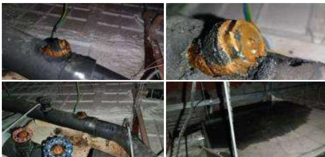
Identificado vários vazamentos de ar, por problema em comum, fissura tampa filtro Y.
