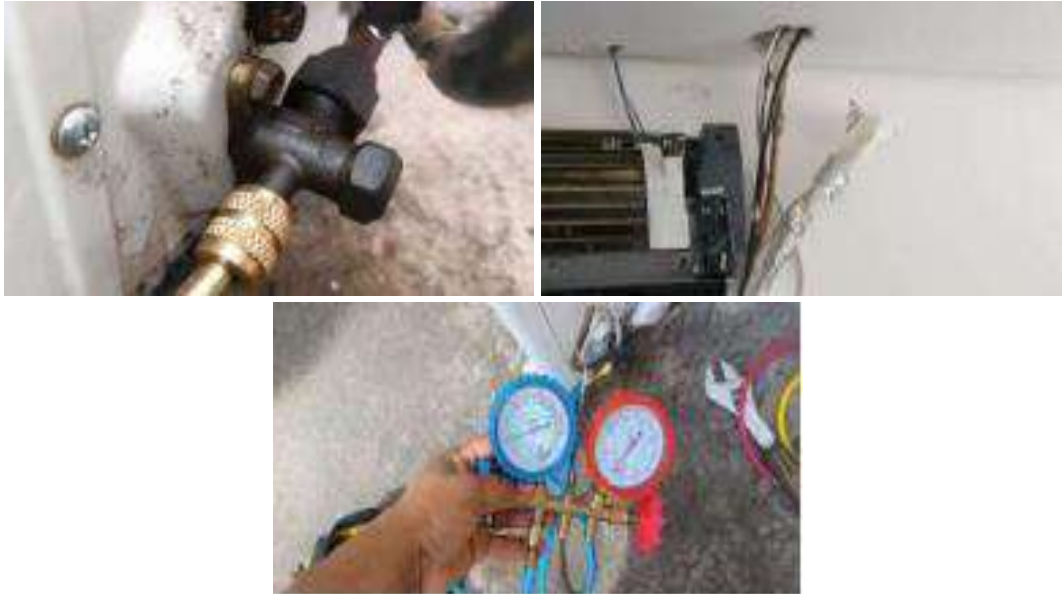
Constatação de vazamento em máquinas
